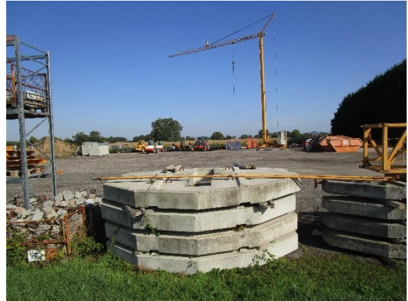
Geschotterter Bereich mit abgelagerten Baumaterialien.
